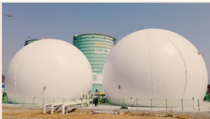
Biogas. Un gasometro costruito da Ecomembrane
